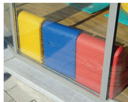
Fig. 2 Exemple de casse thermique sous l'influence de l'environnement interne
